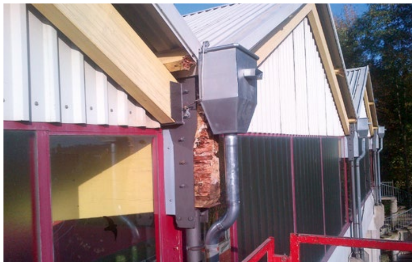
Leimholz-Binderköpfe des Stadion-Tribünendachs verfault: Grundsanierung erforderlich.
